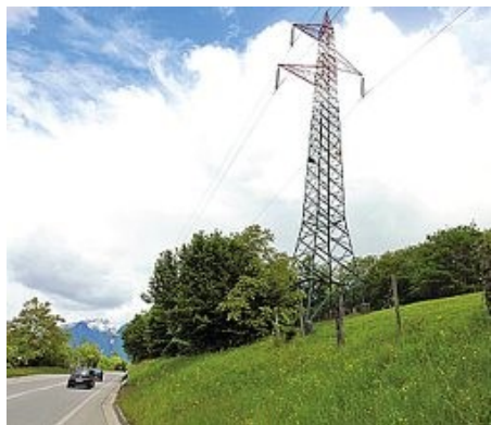
L'alta tensione. Tralicci di Terna nel comune di Ponte nelle Alpi
